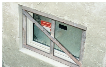
5. Die Stützkreuze verbleiben bis zum Abschluss der Rohbauphase zum Schutz vor Beschädigungen in dem Leibungsfenster.
